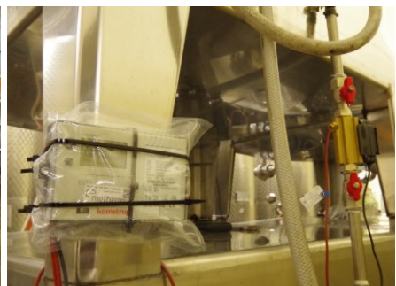
Abb. 3 Kältezähler zur Erfassung der thermischen Energie bei der Gärkühlung.
